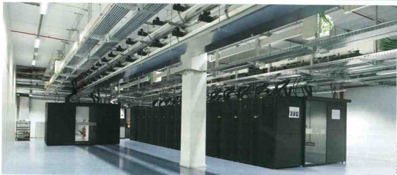
Salle informatique du CC-IN2P3, l'une des plus importantes plateformes académiques de traitement de très grandes masses de données en France.
